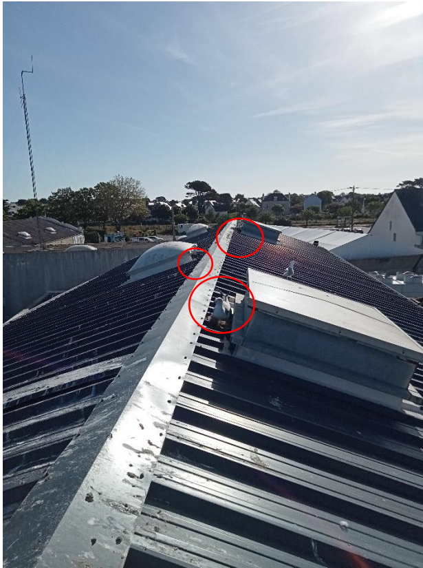
Photo 2 : Nids de goélands argenté, observé directement sur le toit
