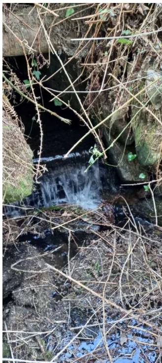
Fig.23 Discontinuité en aval de la route communale
