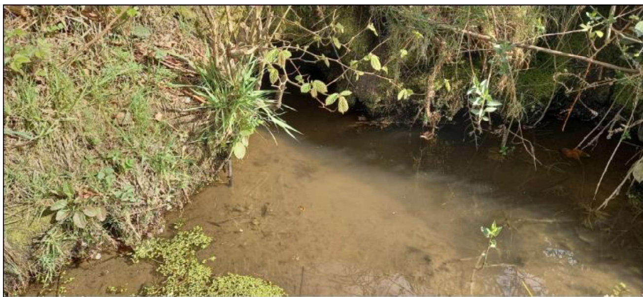
Fig.14 Buse obstruée au niveau de la route communale
