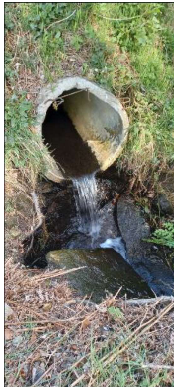
Fig.18 Discontinuité en aval de la départementale
