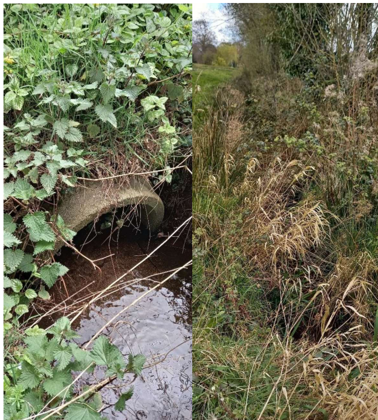
Fig.8 et 9 ruisseau de Keralvy au niveau et en amont de la route Keralvy
