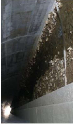
Photo 76- Exemple de barrette échancrée intégrée dans le substrat reconstitué en fond d'ouvrage
