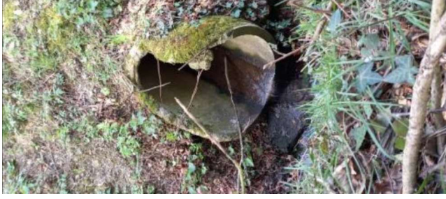
Photo 20- Buse (OH1c) sous la RD775 créant une discontinuité (source : Fédération de pêche 56)
