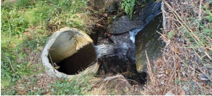
Photo 18- Buse (OH2c) sous la RD775 créant une discontinuité (source : Fédération de pêche 56)
