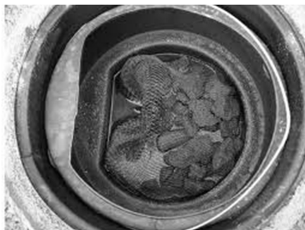
Préfiltre à pouzzolane
