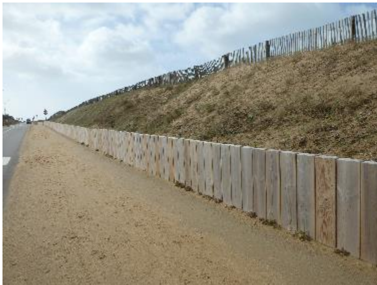
Photo 20 : Exemple de mise en place d'une ganivelle en haut de dune sur une voie verte (photo : département du Morbihan)
