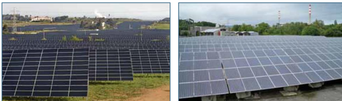
Photo 2 : Installations fixes au sol
